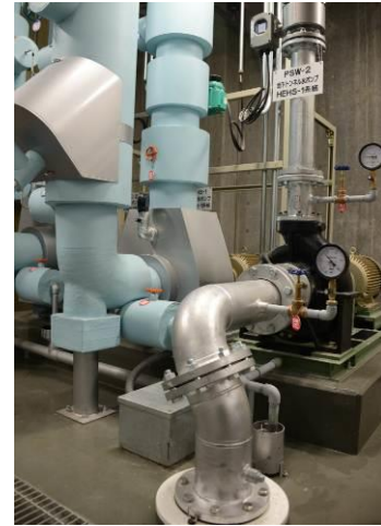
<地下トンネル水配管>
