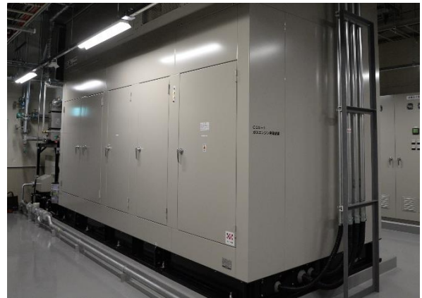
【参考 ガスコージェネレーションシステム】
