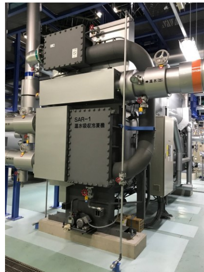
廃熱回収温水吸収式冷凍機
