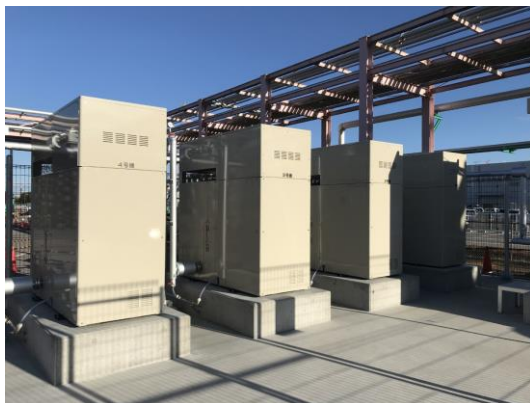
バイオガス発電設備 25kW×4 基
