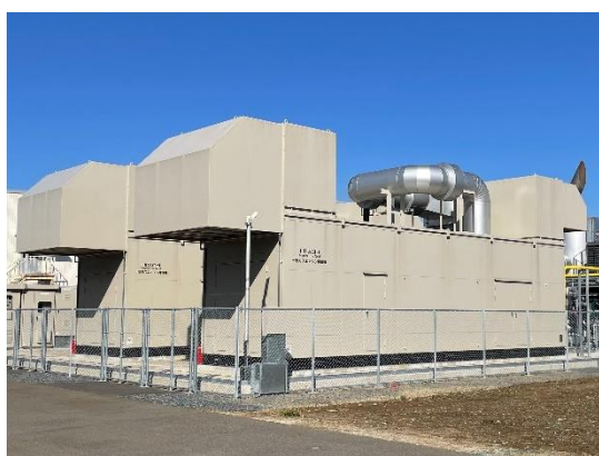
ガスコージェネレーション設備
