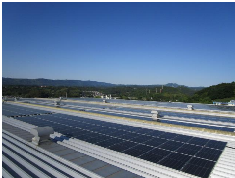
太陽光発電設備設置状況
